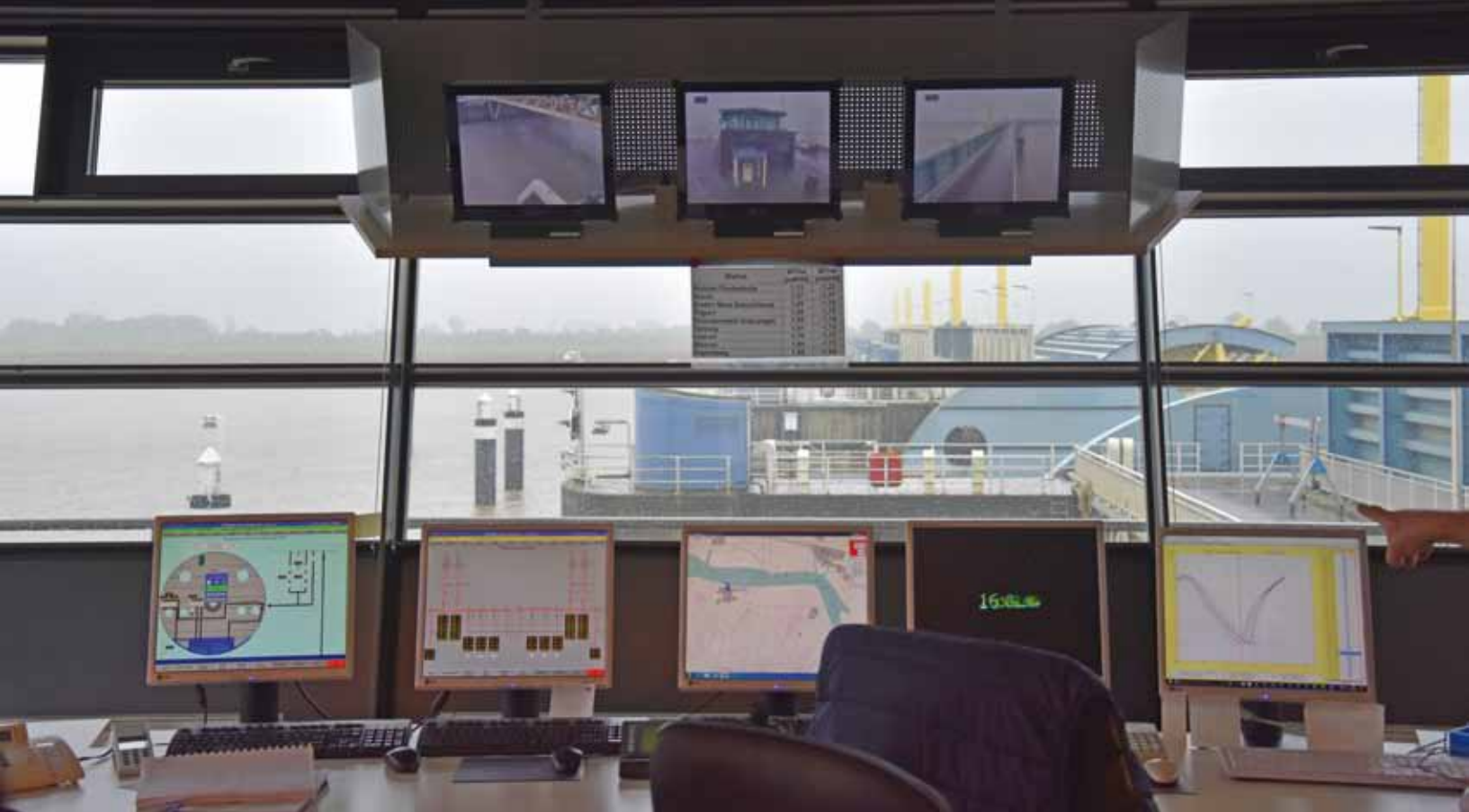
Blick aus dem Leitstand des Emssperrwerks: Der technische Test der Tidesteuerung hat belegt, dass das Bauwerk technisch und statisch für den täglichen Einsatz geeignet ist.
