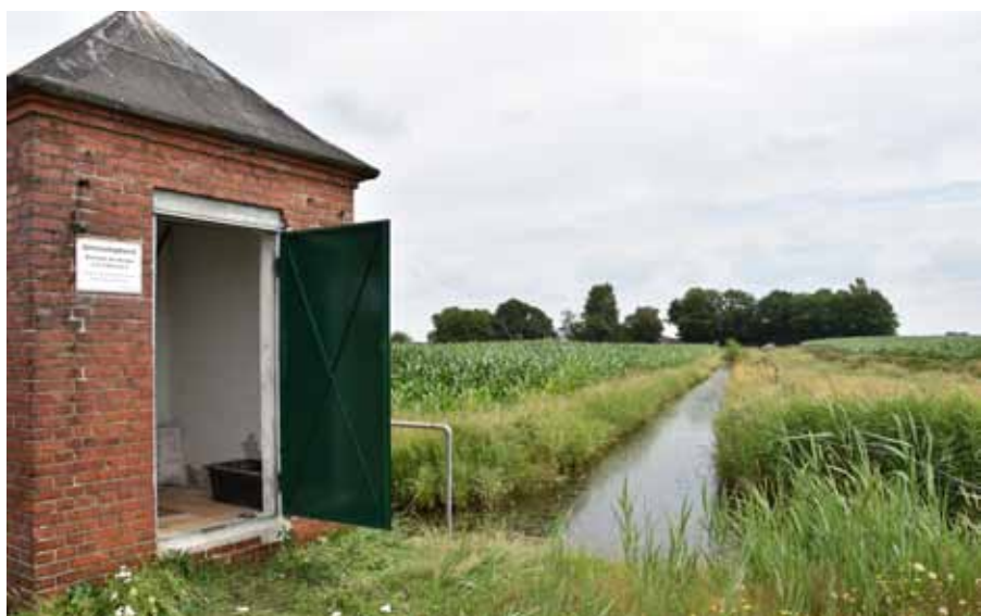
Verstärkung: Im Schöpfwerk Groß Sande soll künftig eine leistungsfähigere Pumpe wirken
