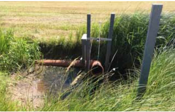
Regler für den Wasserstand: Die Staatliche Moorverwaltung hat diese regelbaren Abläufe installiert
